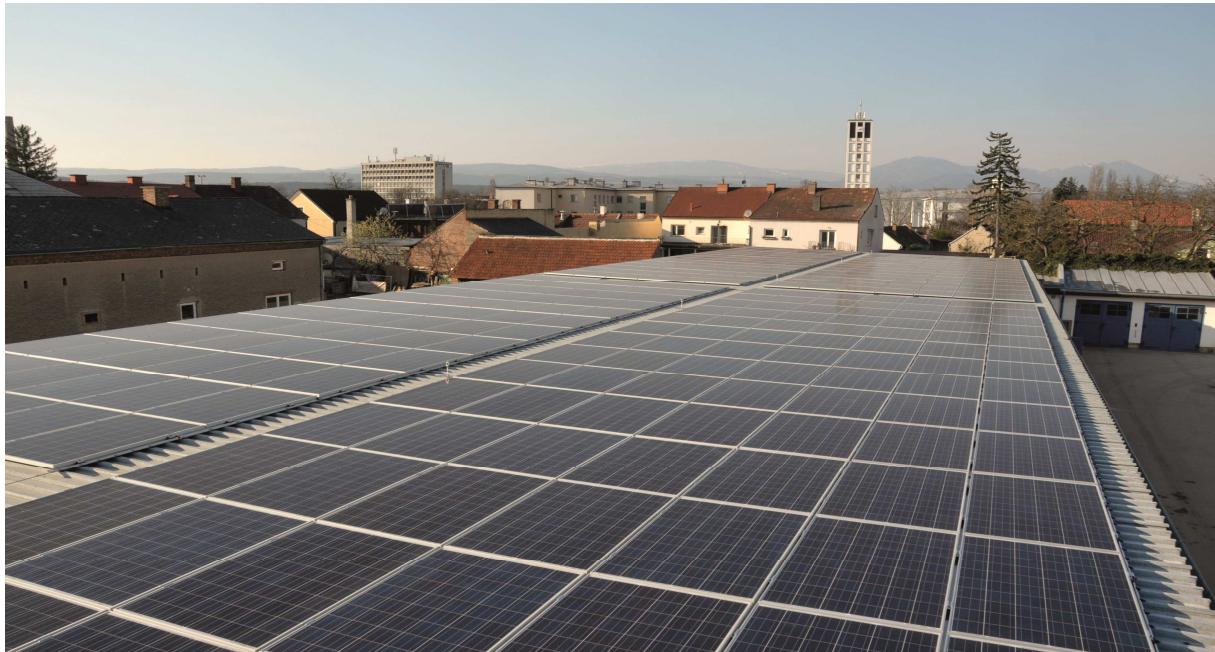
Bild: Photovoltaikanlage am Garagendach des städtischen Bauhofes
