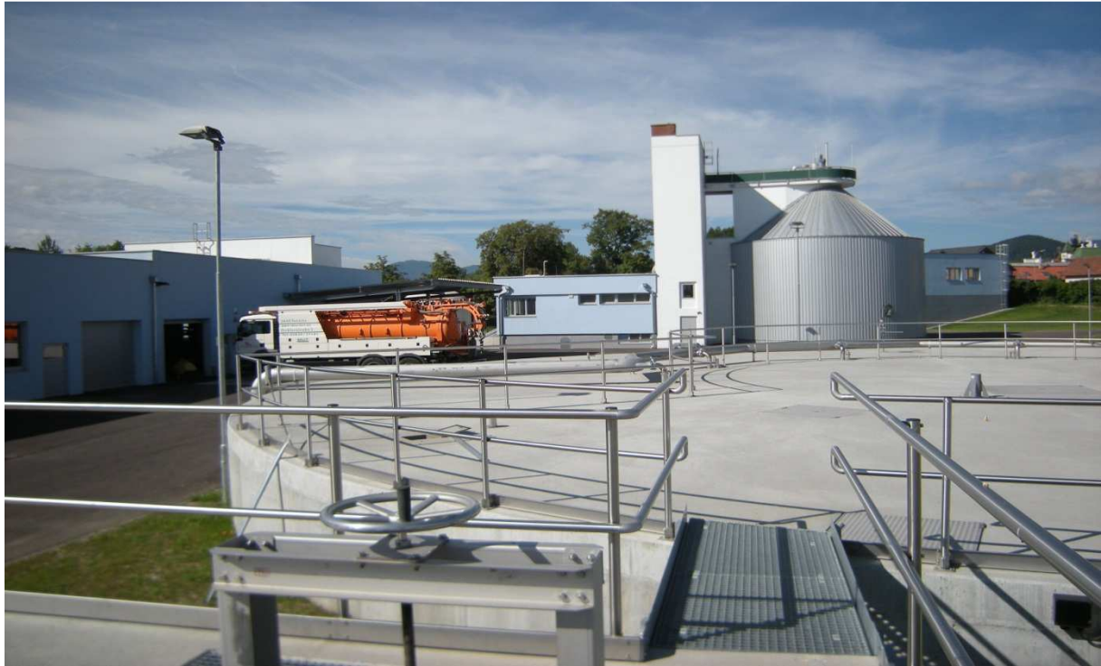
Bild: Teilansicht der Kläranlage des Abwasserverbandes Mittleres Schwarzatal
