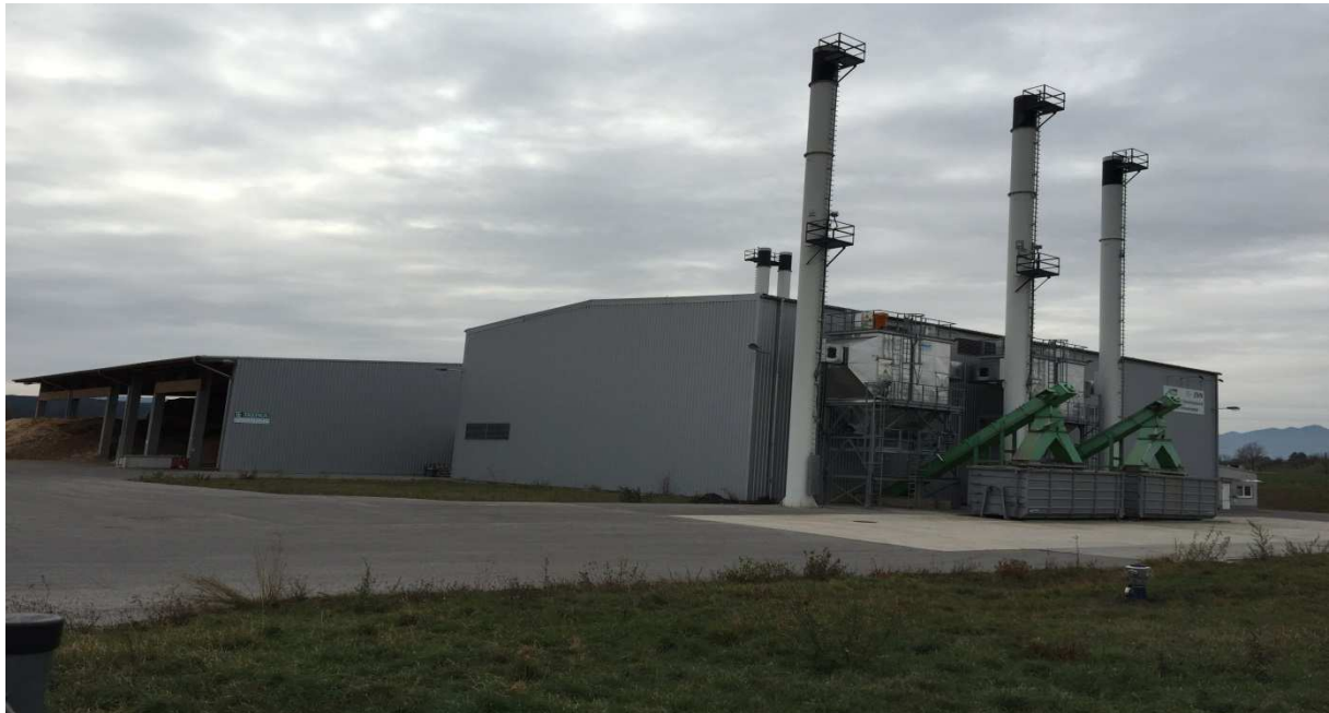
Bild: Biomasseheizwerk Mittleres Schwarzatal
