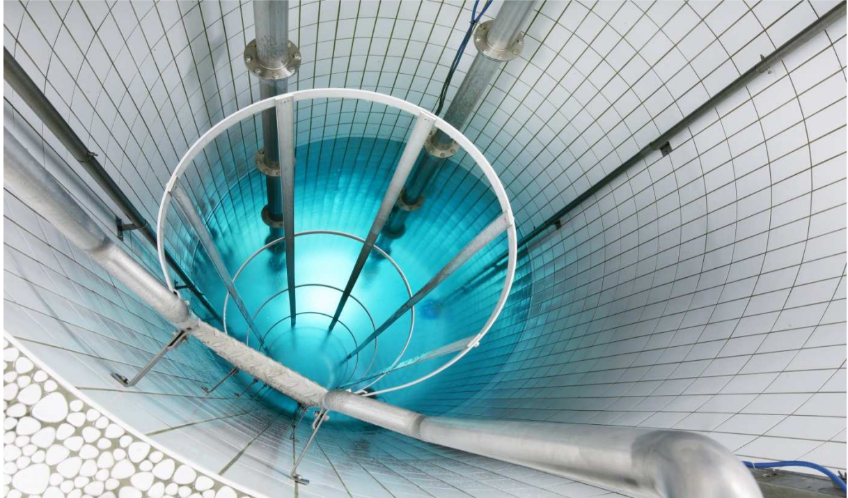
Bild: Neuer Horizontalfilterbrunnen im Brunnenfeld St. Johann
